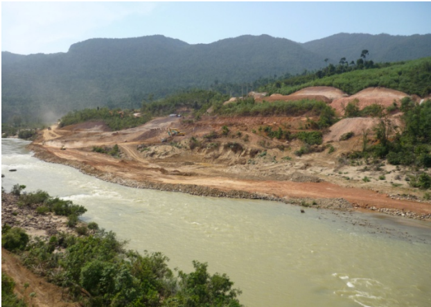
Thủy điện Sông Bung 5 – Chuẩn bị thi công hố móng công trình (3/2010)
