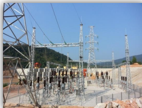
Thủy điện Sông Bung 5 Trạm biến áp 110kV ( 4/2013)
