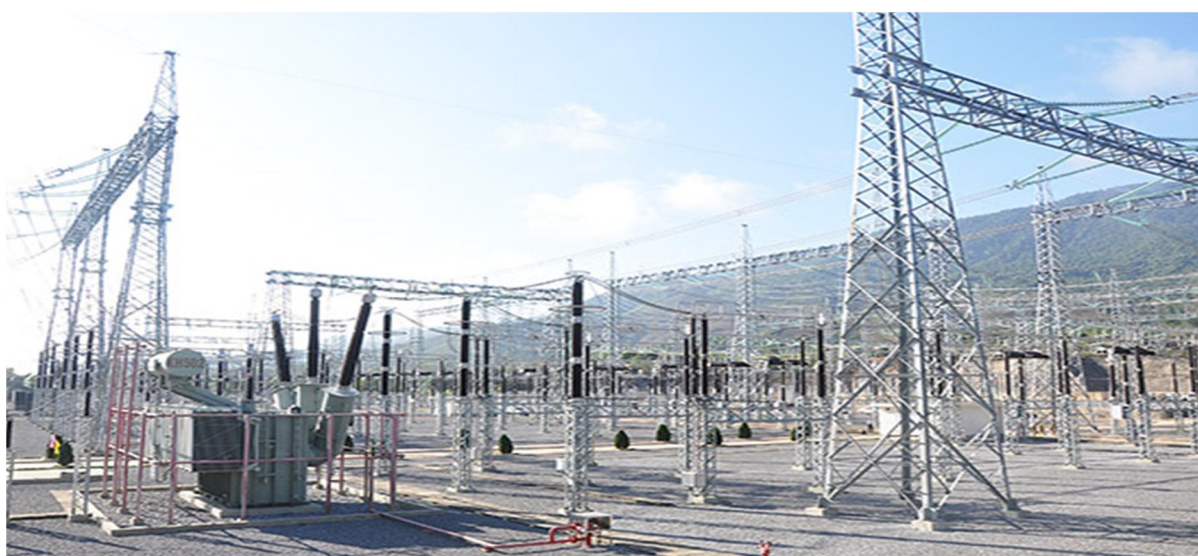
Trạm biến áp 500kV Sơn La
